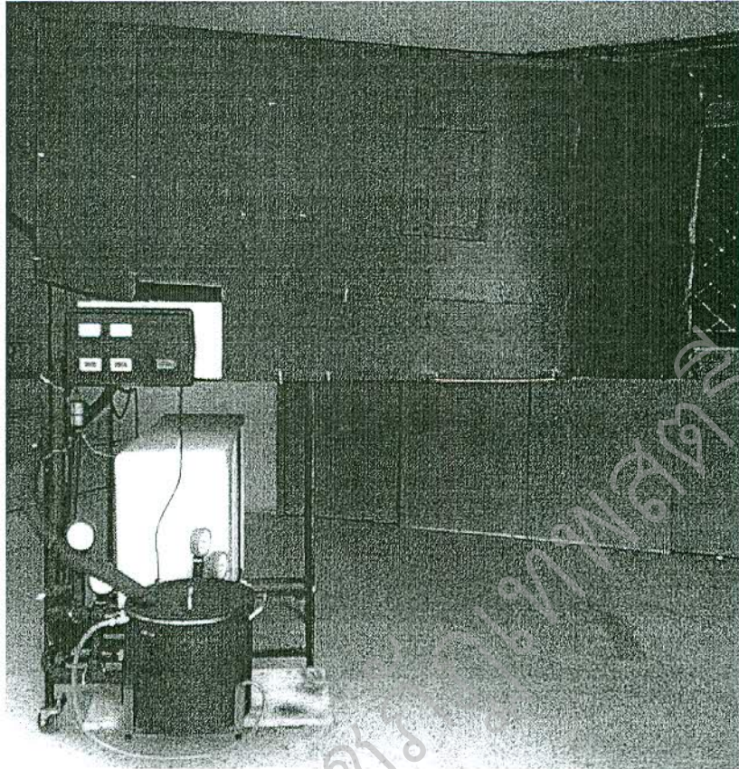
รูปที่ ก.1 ระบบปรับอากาศขนาด 3.52 kW (12,000 BTU/hr)
