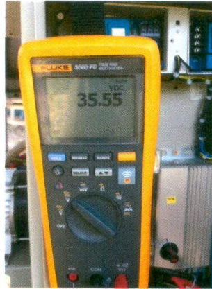
รูปที่ 4.2 แสดงการวัดแรงดันขณะแผงโซลาร์เซลล์ทำงาน ขณะยังไม่มีโหลด
