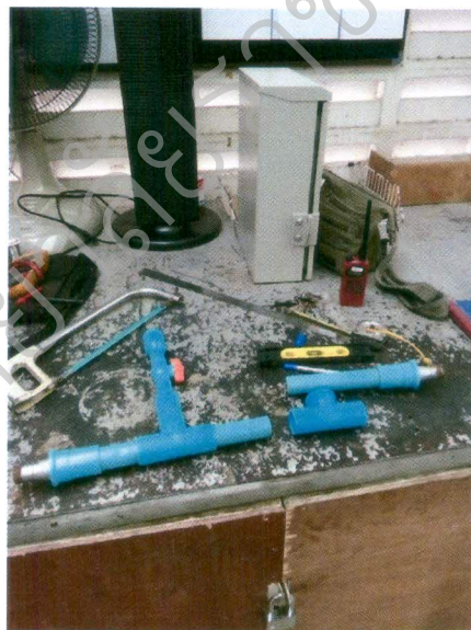
รูปที่ ข. 2.3.2 ตัดท่อระบบเดิมออกเพื่อทำการใส่ โฟลว์สวิตช์
