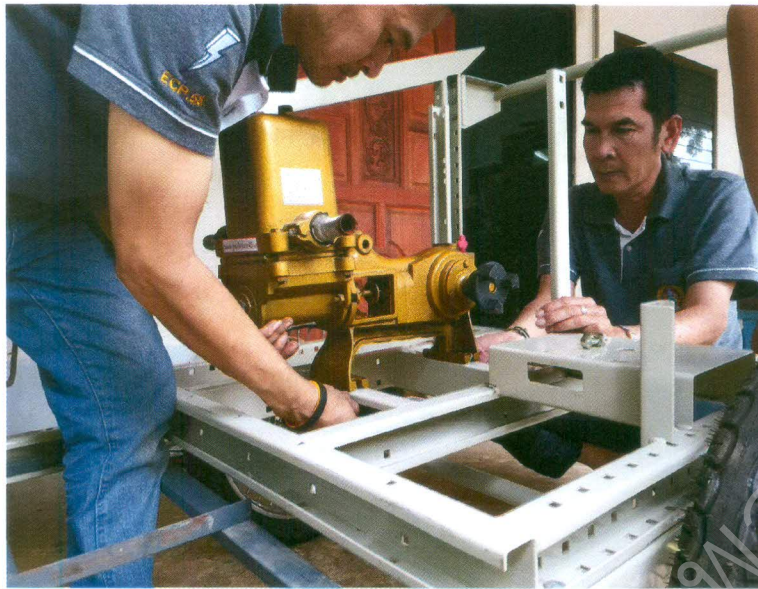
รูปที่ ข 2.1.3 ประกอบปั้มน้ำเข้าโครงเครื่อง
