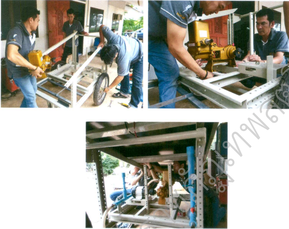
รูปที่ 3.17 การติดตั้งพื้นที่วางอุปกรณ์เครื่องสูบน้ำแบบ BLDC มอเตอร์ ของบริษัท DENCO
