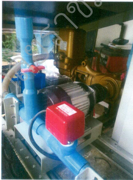
รูปที่ ข2.3.4 ติดตั้งที่เครื่องสูบน้ำ
