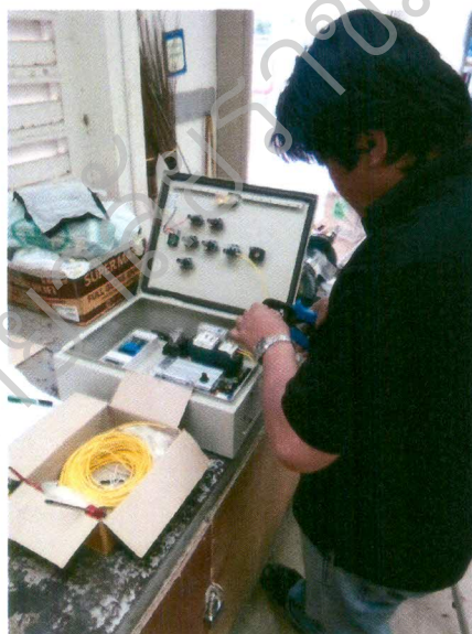
รูปที่ ข.2.2.10 เดินสายไฟฟ้าชุดคอนโทรลหลัก
